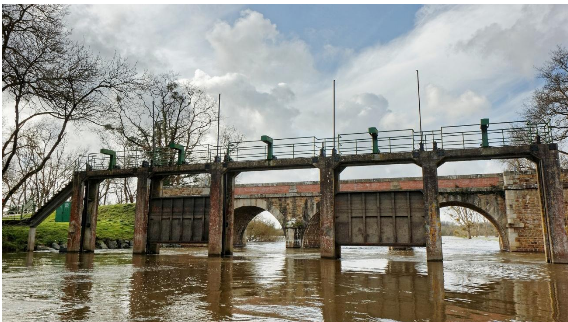
Figure 23 : le vannage de Bouaye, seule installation contrôlant le niveau du lac, février 2020 (JM Gillier, SNPN – RNN Lac de Grand-Lieu)
