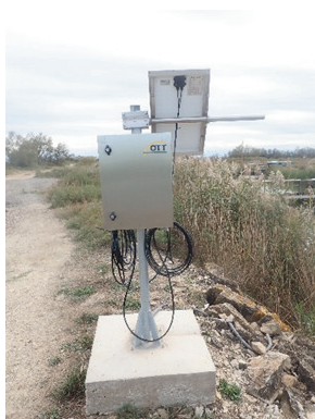
Débitmètre au canal de rousty
